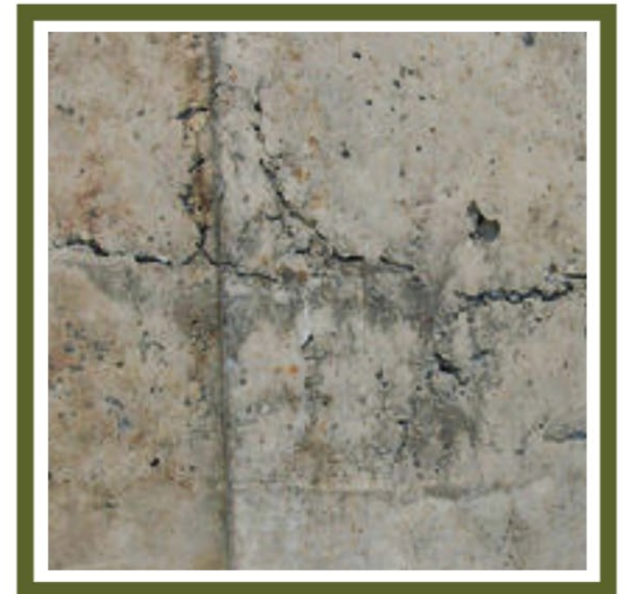
Figure 1. Exemple de joint froid formé dans un mur de béton
