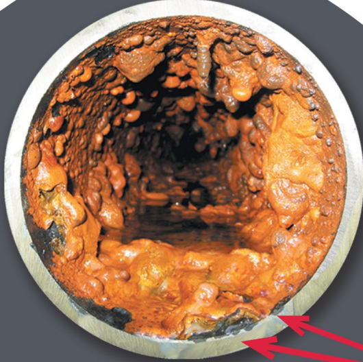
Conduite de 150mm de 45 ans en fonte
